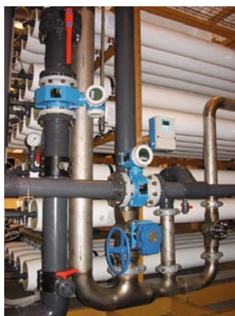
Figura 32. Detalle de las cajas de presión. Por cortesía de AQUAESPÑA
