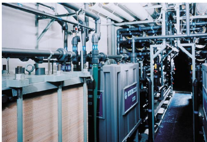
Figura 36. Unidad de EDR en contenedor. Por cortesía de GE Water & Process Technologies
