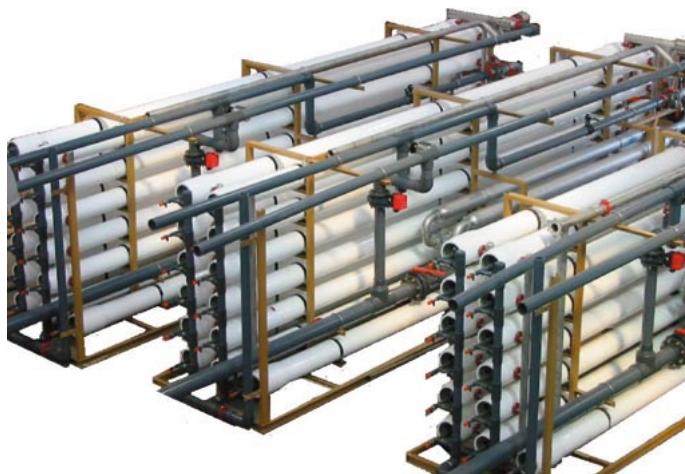
Figura 25. Aspecto de los bastidores con las cajas de presión. Por cortesía de AQUAESPANA
