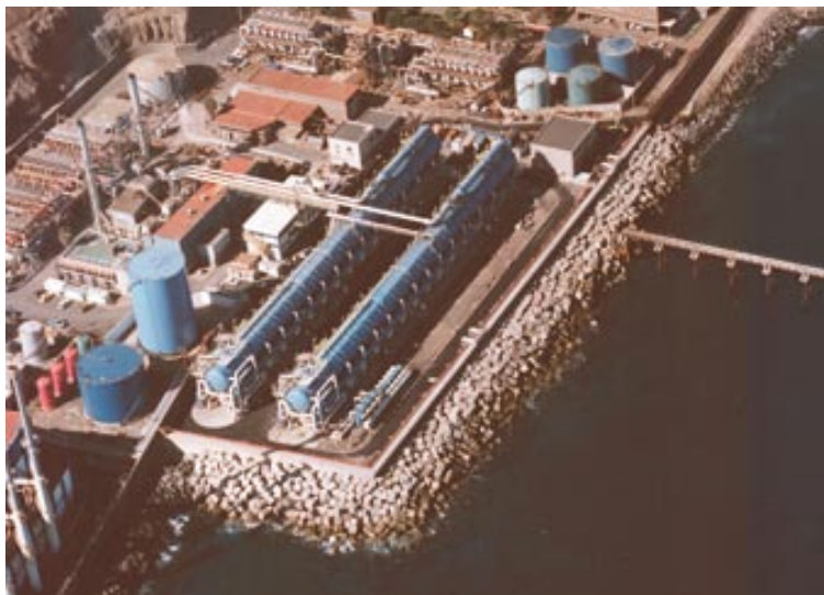
Figura 37. Conjunto de plantas de desalación por destilación en Gran Canaria. Por cortesía ECOAGUA INGENIEROS
